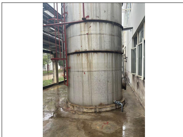
氨水罐无围堰
