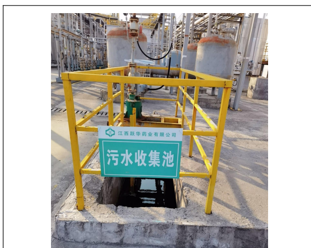
污水收集池未加盖
