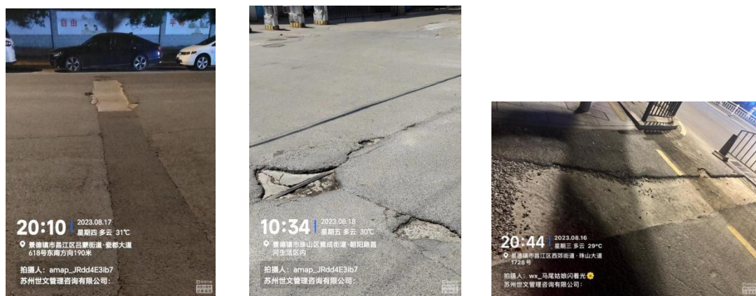
图 6-2 道路破损严重
